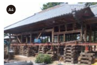
揚げ屋工事 ：再利用部分を残し解体した後、土台に鉄骨を通し、建物全体を持ち上げ、基礎工事の準備をする。
