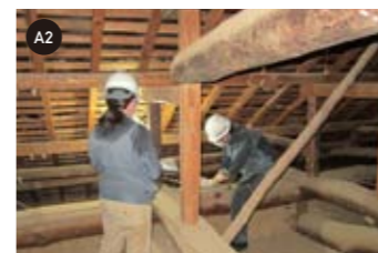
現地調査 ：実際に現場を見て採寸し図面にする。この時に既存の梁や柱の腐朽、老朽化、雨もり等を入念に調べる。
