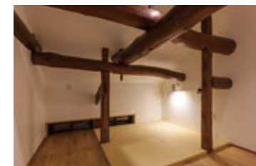
太い梁を間近に見ることができ隠れ家のような小屋裏
